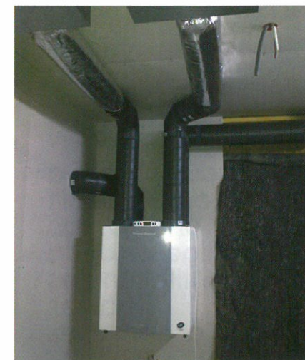
Centrale Renovent Excellent 300 installée dans une maison neuve (67)
