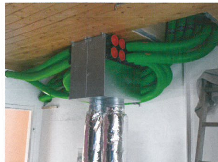
Réseau de distribution d'air circulaire - Air Excellent System installé dans une maison en rénovation (73)
