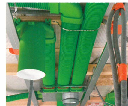
Réseau de distribution d'air semi-circulaire Air Excellent System installé dans une maison neuve (13)
