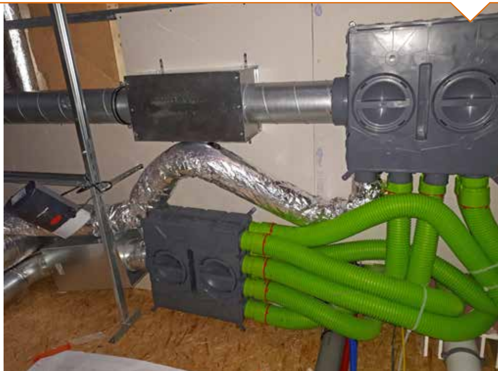
Boîtiers de distribution et amortisseur de bruit au plafond du LT 2.
