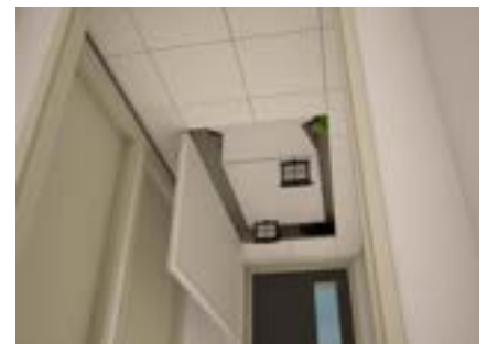
Vue de dessous - Entretien de filtres
