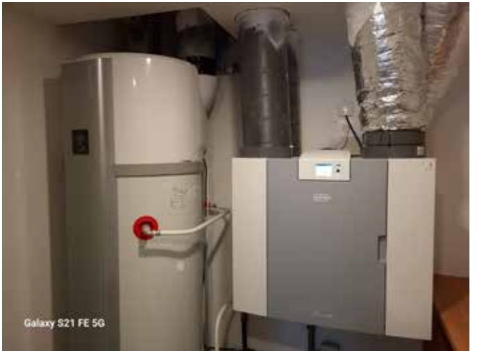
La VMC et le ballon thermodynamique situés dans la buanderie. L'entretien est assuré par l'installateur Sebelec.
