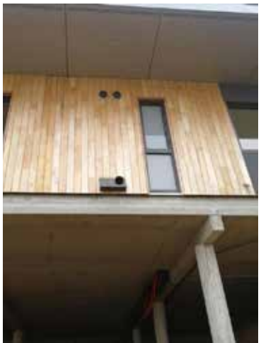
Le terminal rejet/prise d'air visible en façade.
